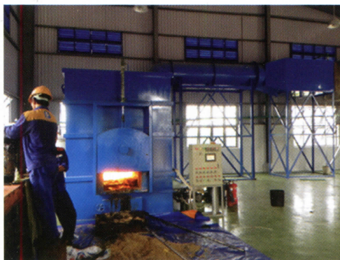
Công nghệ áp suất âm - mở cửa lò trong khi đốt Negative pressure technology-open door durring operation
